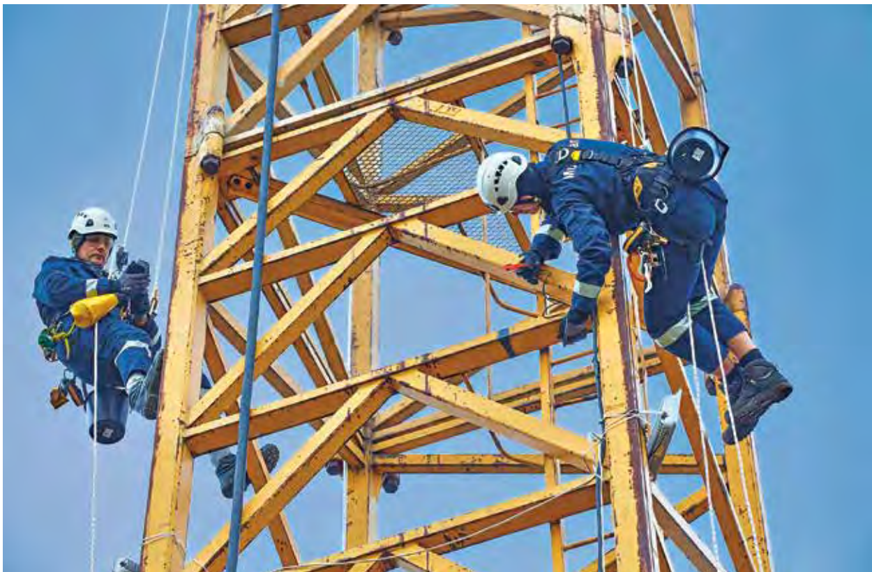
Zugangstechnik mit Seilkonstruktion
